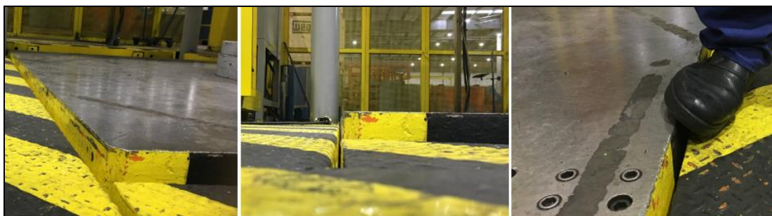
Figura 16 - Degrau/desnivelamento do piso.
