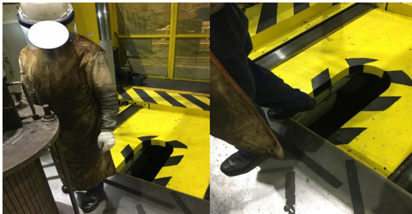
Figura 12 - Risco de queda ao fosso sob a prensa Calende.
