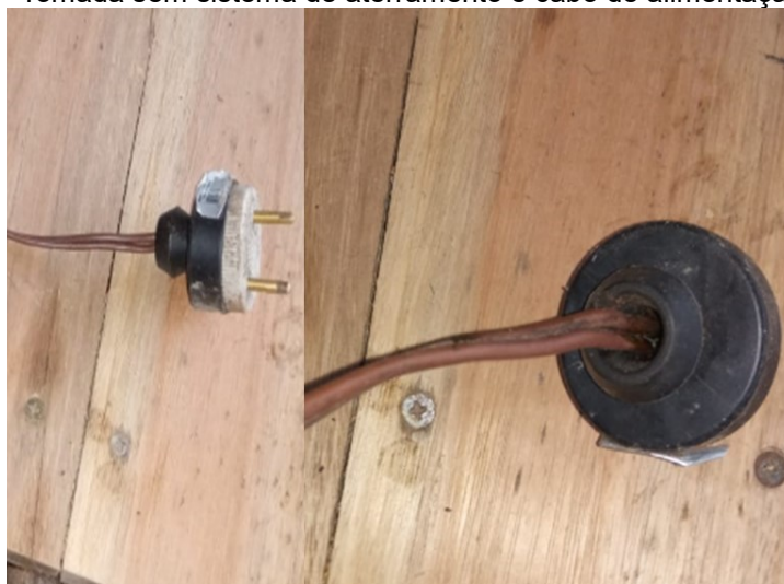
Figura 6 – Tomada sem sistema de aterramento e cabo de alimentação simples.
