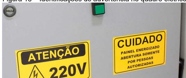
Figura 13 – Identificações de advertência no quadro elétrico.
