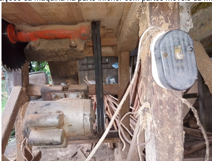
Figura 2 – Condições da máquina na parte inferior com partes móveis da máquina expostas.
