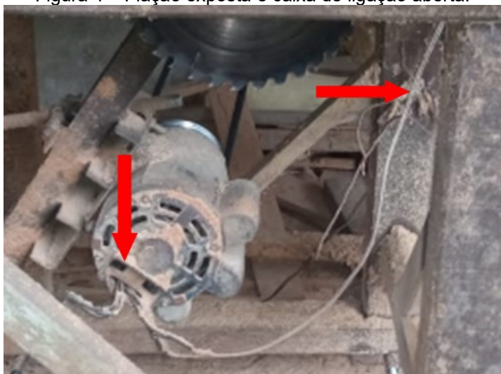
Figura 4 – Fiação exposta e caixa de ligação aberta.
