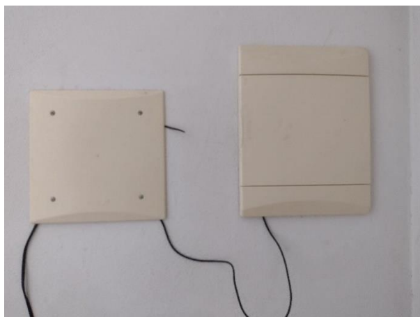
Fig. 23: Dispositivo de monitoração de consumo instalado (Foto 3).
