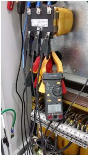
Figura 20 - Fotografia da ligação e do equipamento analisador de qualidade de energia Fluke434 II.
