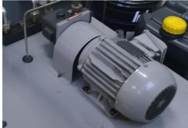
Figura 29 - Proteção do acoplamento do motor na unidade hidráulica da retificadora plana RP.
