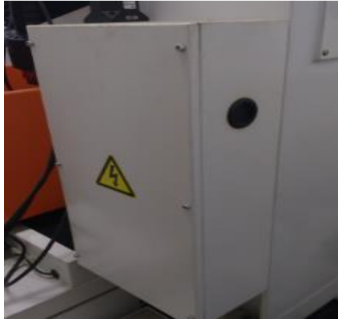
Figura 42 – Painel de alimentação da máquina de eletro erosão por penetração EP.
