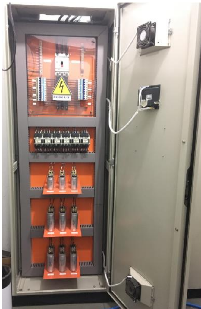
Figura 76 – Pannel elétrico do banco capacitivo correspondente ao QGBT- 4
