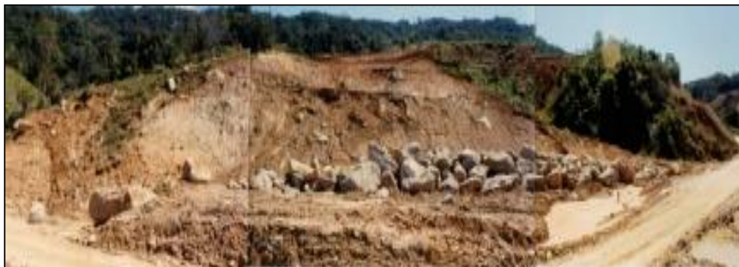
Figura 10: Talude erodido na área de terraplanagem da rodovia SC-431. Fonte: Relatório da obra. Construtora: CONTER – S/A. Supervisora: IGUATEMI – Consultoria e serviços de engenharia LTDA.
