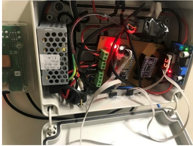
Figura 45 - Painel elétrico aberto
