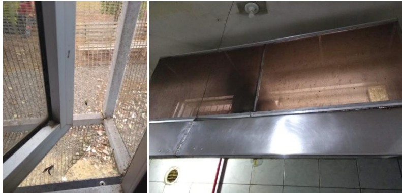
Figura 3: Tela de proteção rompida e com sujidades.
