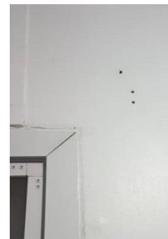
Figura 7: Buracos na parede
