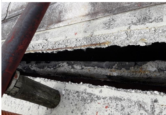
Figura 24 - ETE Barra da Lagoa – Oxidação de armaduras
