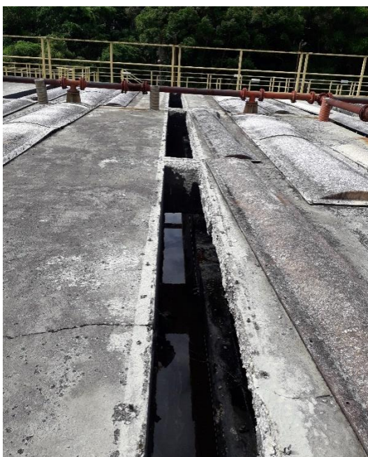
Figura 23 - ETE da Barra da Lagoa - Degradação do concreto das canaletas e fissura
