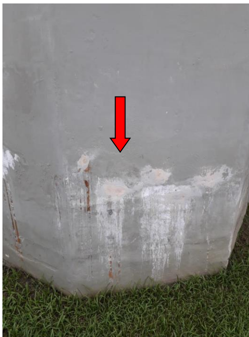
Figura 31 - Eflorescências na parede externa da caixa de distribuição de vazão 1
