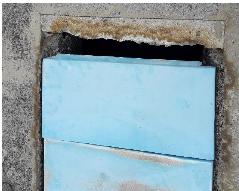
Figura 18 - ETE Saco Grande – Degradação do concreto das canaletas
