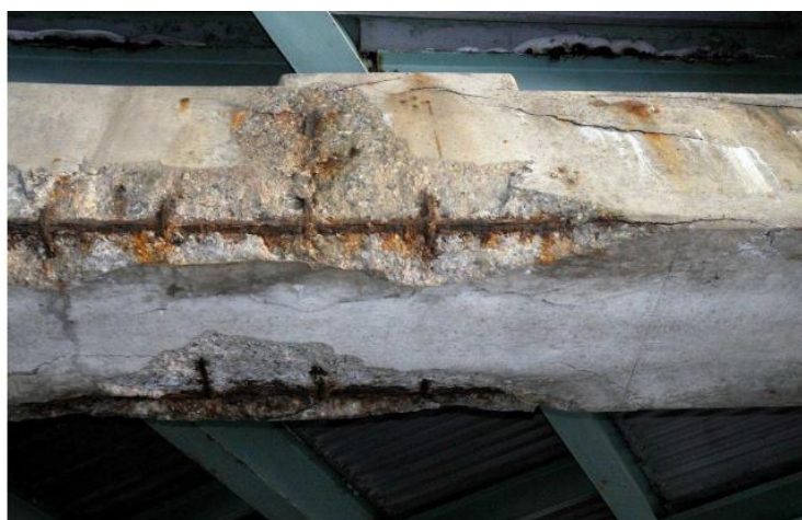
Figura 13 - Fenômeno de carbonatação exposto em viga
