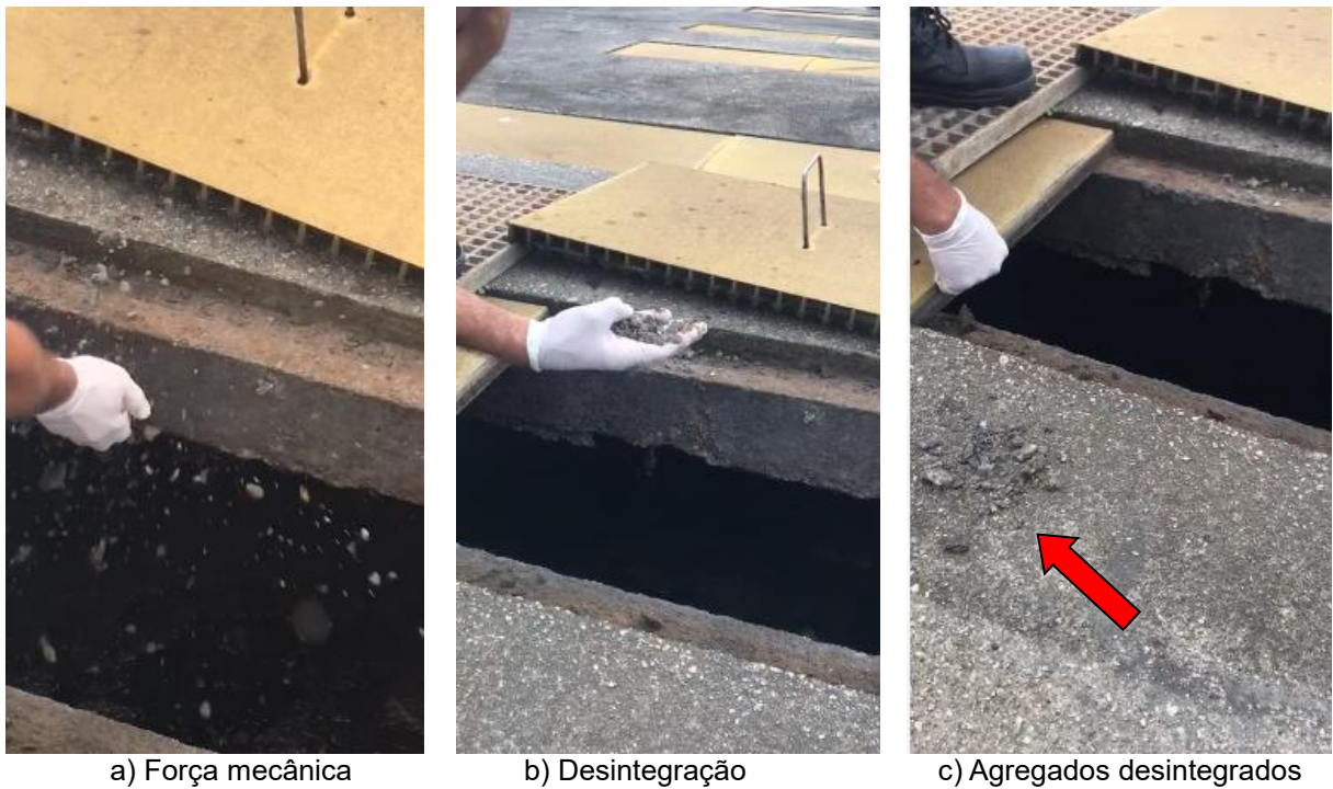
Figura 33 - Desagregação do concreto na laje de cobertura
