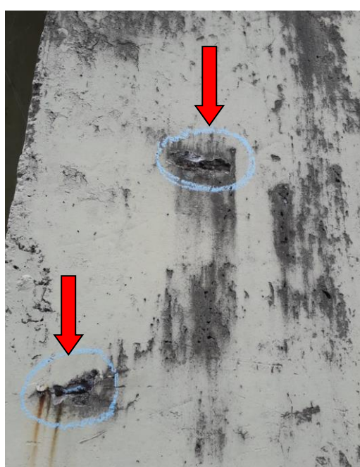
Figura 27 - Exposição da armadura devido à falta de cobrimento
