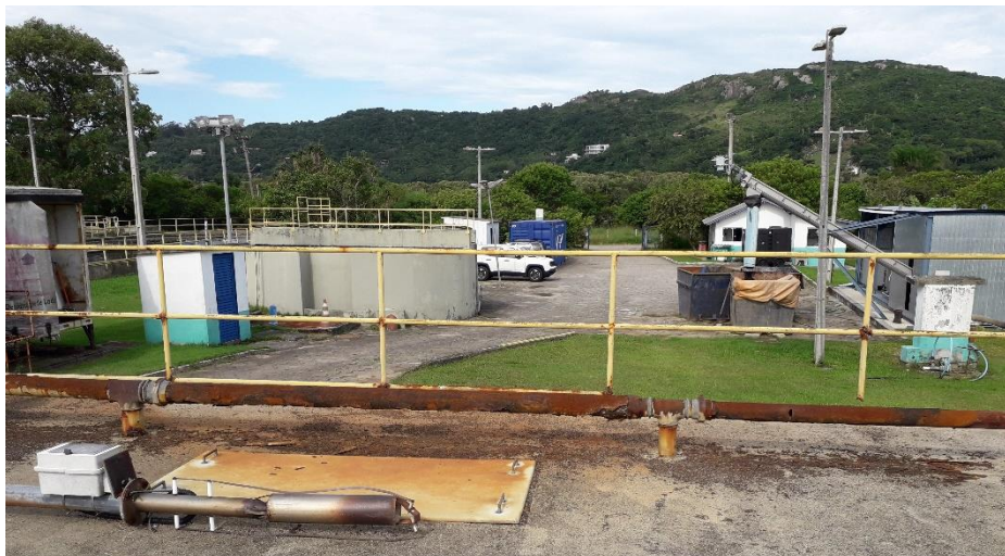
Figura 19 - ETE Lagoa da Conceição – Oxidação da canalização do queimador de gás
