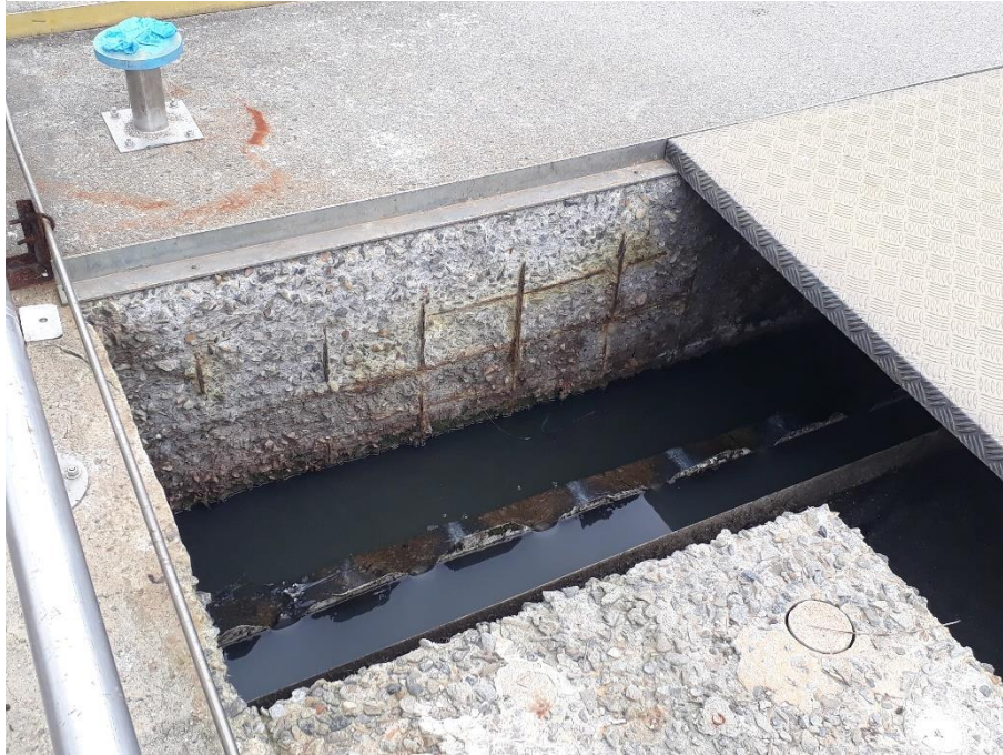
Figura 41 - Desagregação do concreto na parede interna no reator UASB e oxidação da armadura
