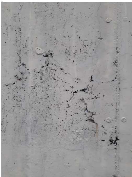
Figura 28 - Falha de concretagem
