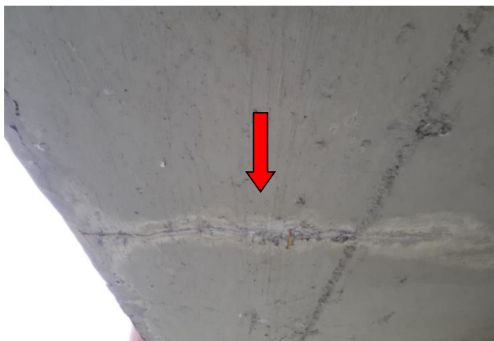
Figura 30 - Eflorescências na parede externa no reator UASB
