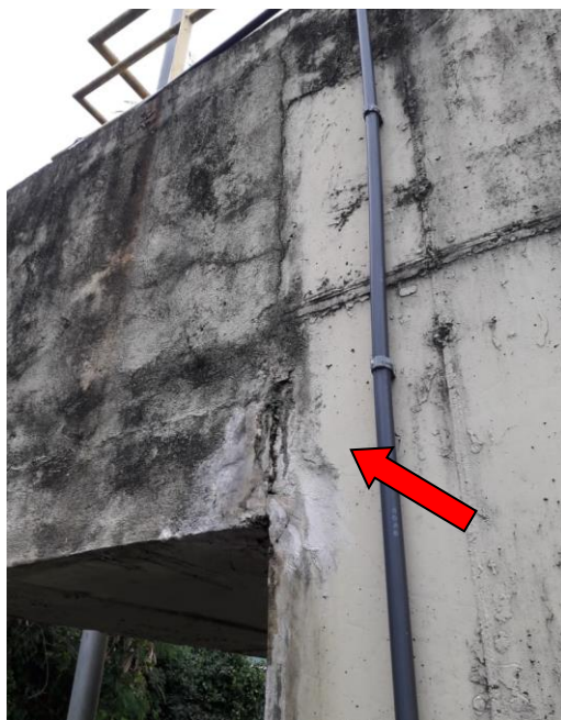
Figura 29 - Fissura na junta de concretagem
