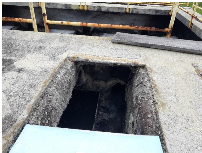
Figura 20 - ETE Saco Grande – Degradação do concreto das canaletas
