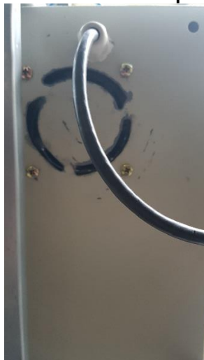
Figura 22 – Vista lateral direita do quadro de comando
