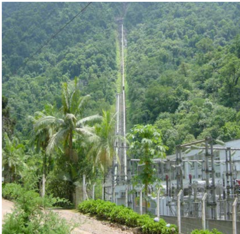
Figura 59 - Conduto forçado e subestação da Usina Palmeiras
