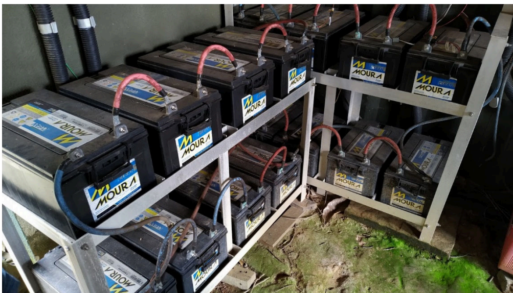
Figura 4 – Banco de bateria para um sistema Off Grid .
