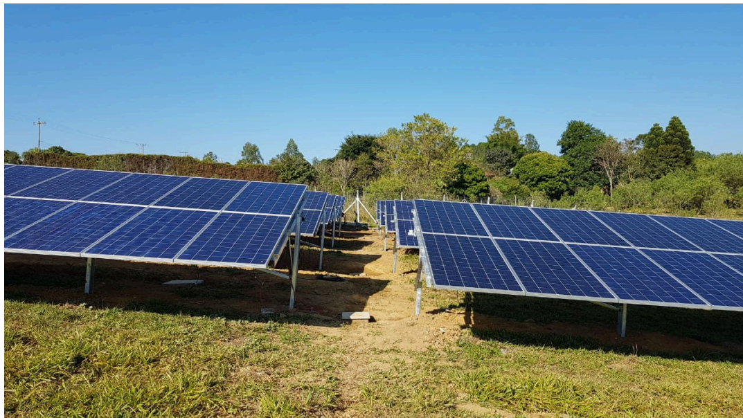
Figura 17 – Vista parcial dos módulos da usina.
