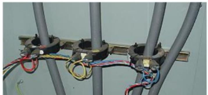
Figura 4 - Transformadores de Corrente. Fonte: AMDS4 (2020)
