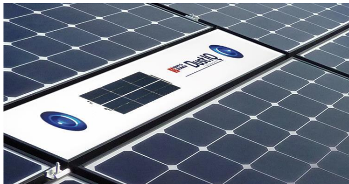
Figura 29 - Equipamento de medição de sujeira DustIQ
