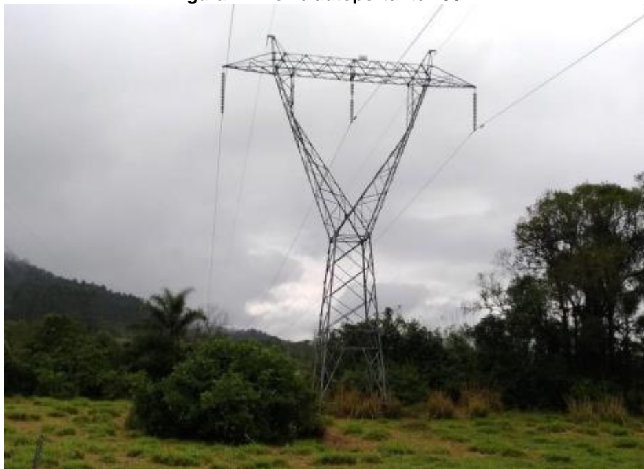
Figura 1 – Torre autoportante 230kV
