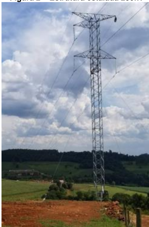
Figura 2 – Estrutura estaiada 230kV
