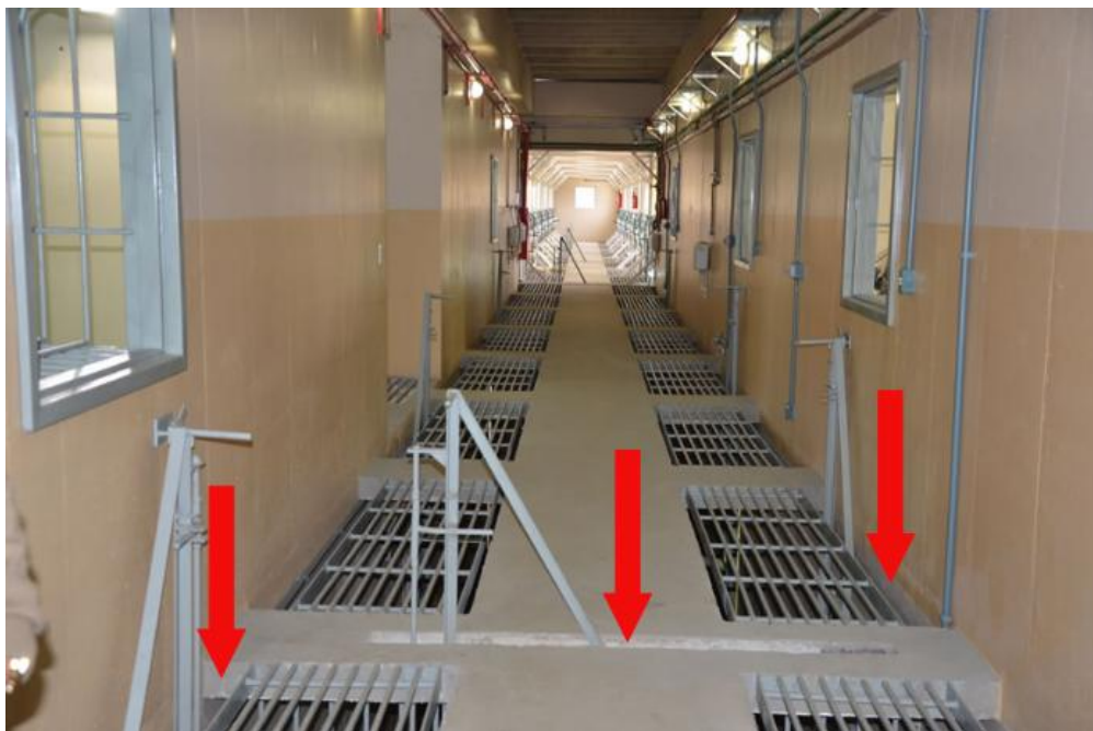
Figura 27 - Aberturas para acionamento das portas.
