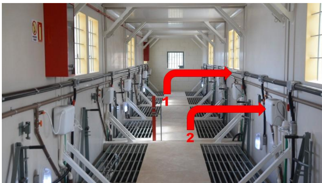
Figura 18 - Vista da circulação superior do módulo de vivência coletiva. Em destaque, (1) as caixas de descarga e (2) as instalações elétricas e hidráulicas
