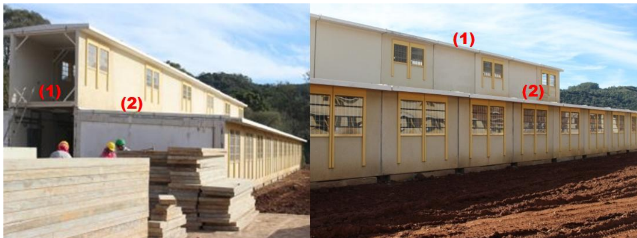
Figura 17 - Corte e Vista lateral do módulo de vivência coletiva de uma edificação semelhante à avaliada. Destaque (1) circulação superior e (2) telhado dos alojamentos
