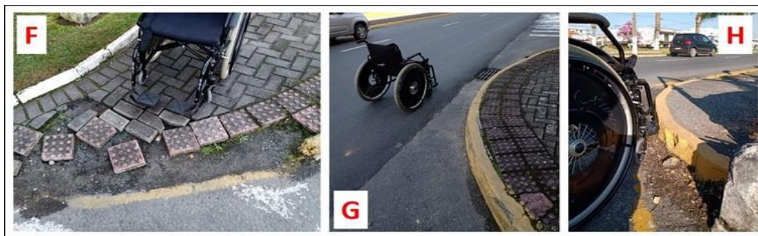
Figura 19 – Rota 2: Trecho 1 pontos F, G e H, criticidade 3.
