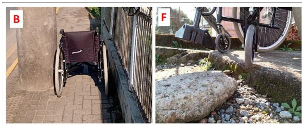
Figura 27 – Rota 2: Trecho 3 pontos B e F, criticidade 3.
