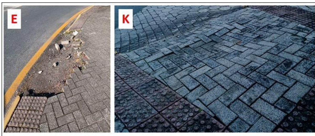
Figura 17 – Rota 2: Trecho 1 pontos E e K, criticidade 1.
