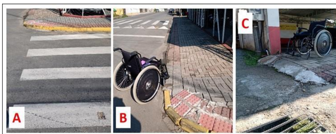
Figura 30 – Rota 2: Trecho 4 pontos A, B e C, criticidade 2.
