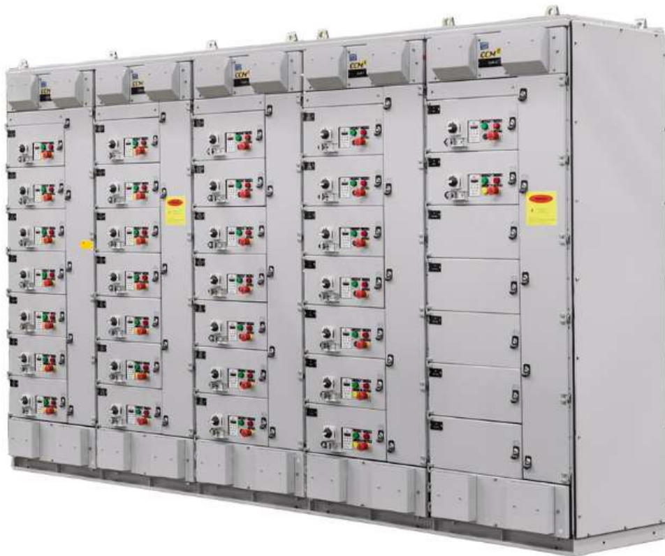
Figura 1 - Quadro Geral de Baixa Tensão (QGBT)
