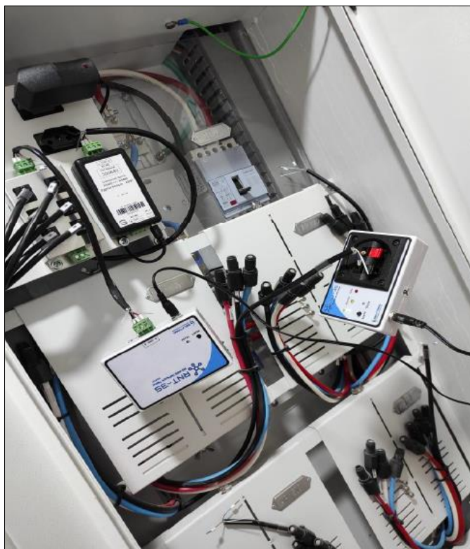
Figura 10 – Foto da caixa de comunicação local instalada.
