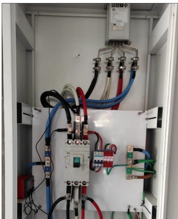
Figura 6 – Foto do barramento blindado.
