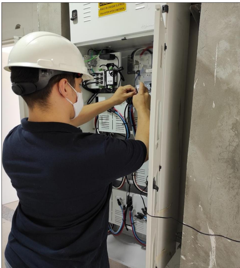
Figura 13 – Foto do quadro medidor sob o barramento.
