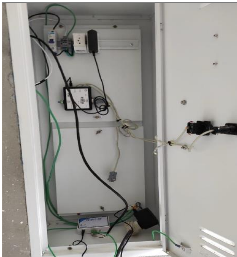
Figura 8 – Foto da caixa concentradora instalada.
