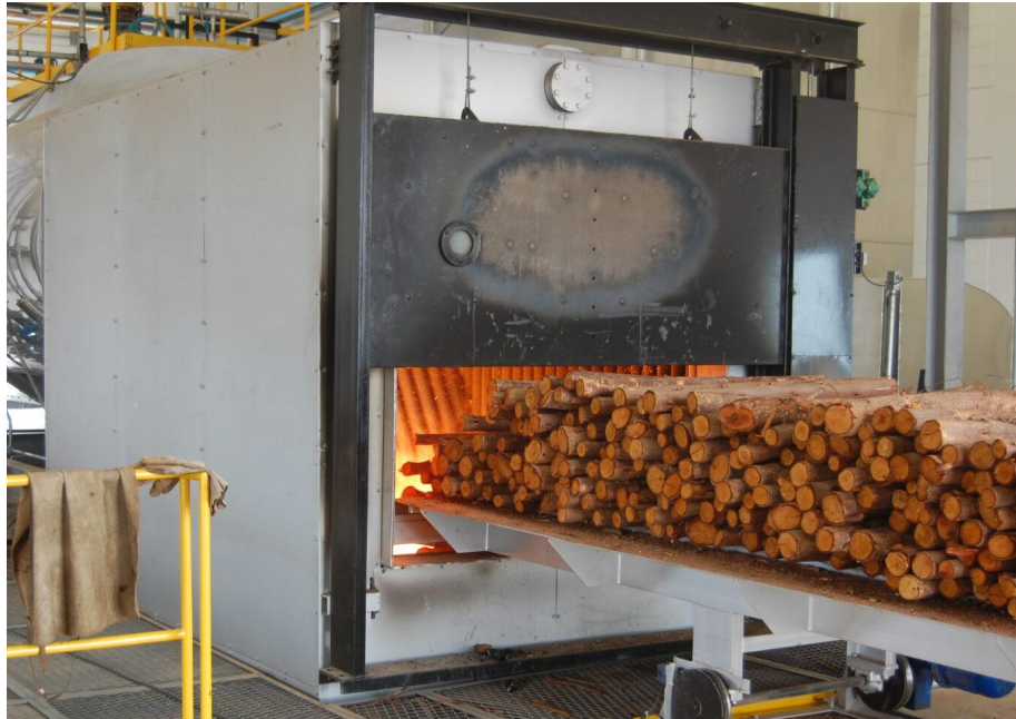
Figura 8 - Caldeira com fornalha para queima de combustível sólido.
