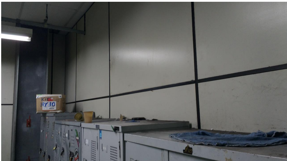
Figura 8 – Área do Vestiário com materiais abandonados sobre os armários
