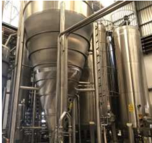
Figura 8: Setor de termovinificação, tanque flash-deténte, marca RICEFER
