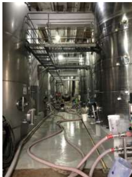
Figura 11: Corredor de tanques de flotação (Cantina 1)
