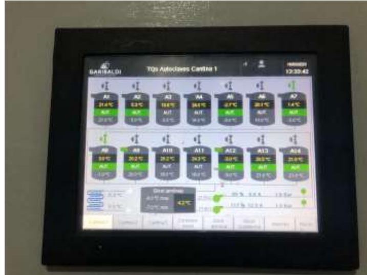
Figura 17: Painel de controle de temperatura de tanques
