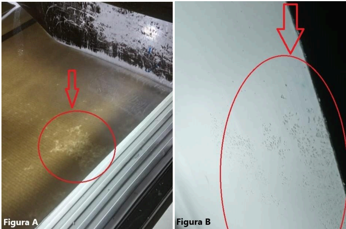
Figura 13 - Defeito em luz específica (A) e Defeito de ar na cabeceira em luz ambiente (B)
