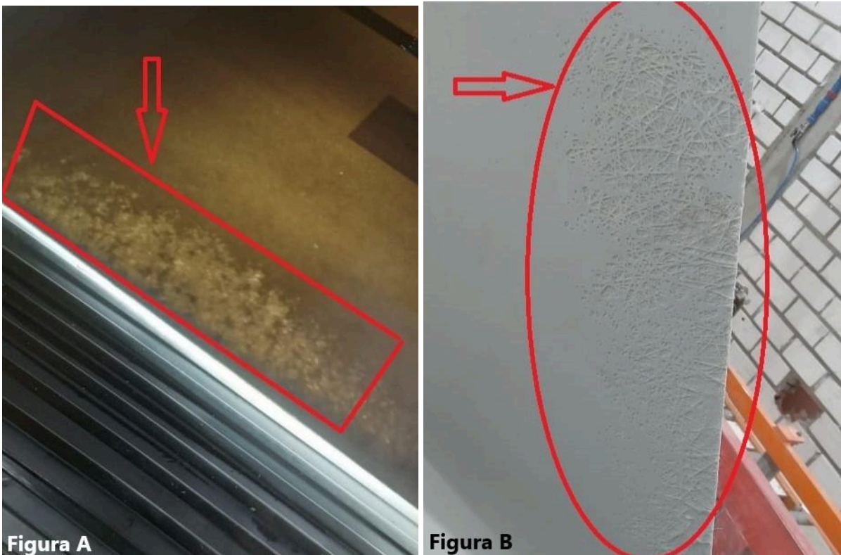
Figura 12 - Defeito em luz específica (A) e Defeito de ar na cabeceira em luz ambiente (B)
