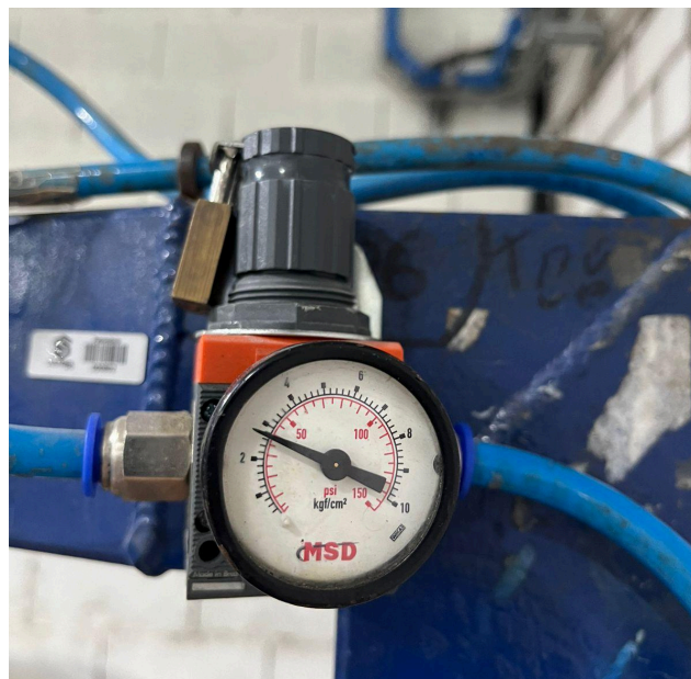
Figura 17 - Válvula reguladora de pressão
