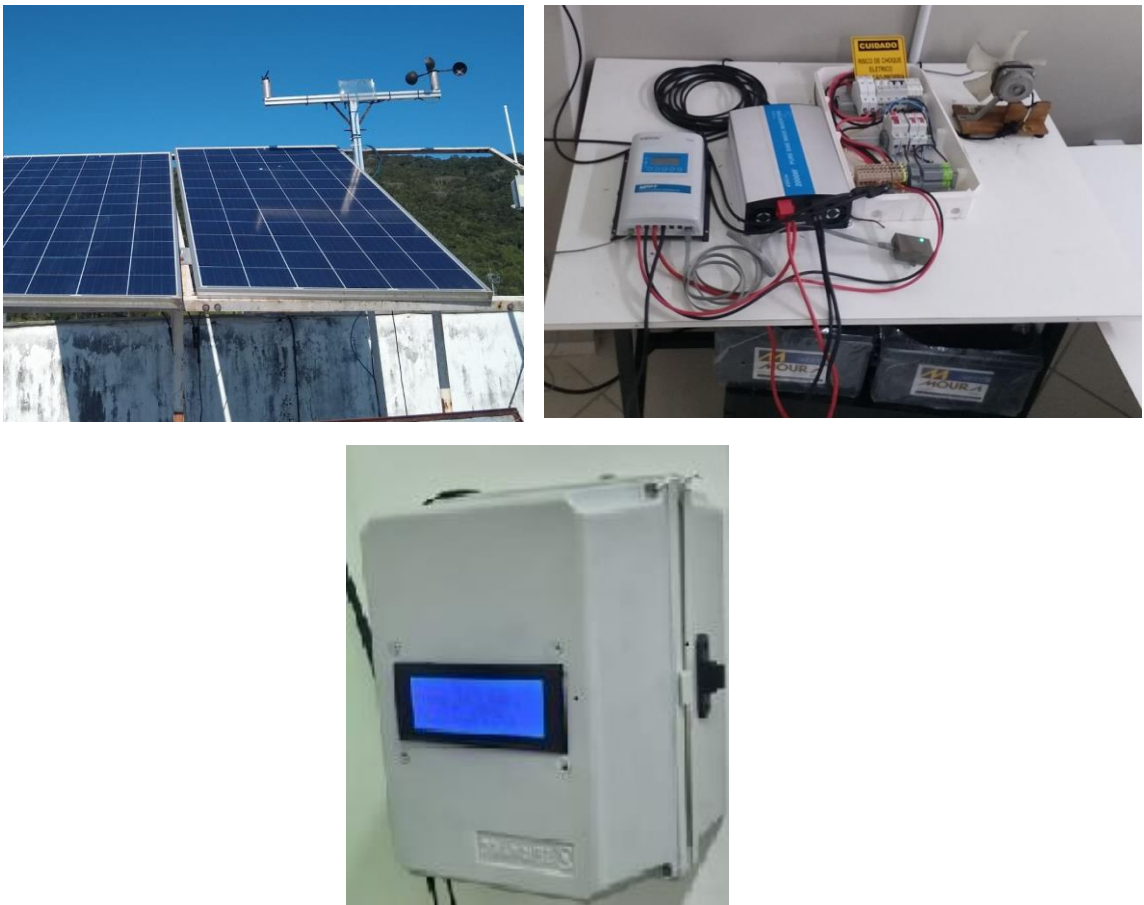
Figura 16 - Equipamento de geração de energia fotovoltaica e coleta de variáveis meteorológicas.
