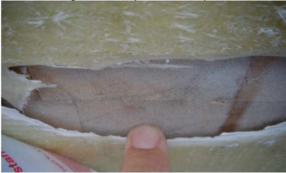
Figura 2 – Delaminação em material compósito
