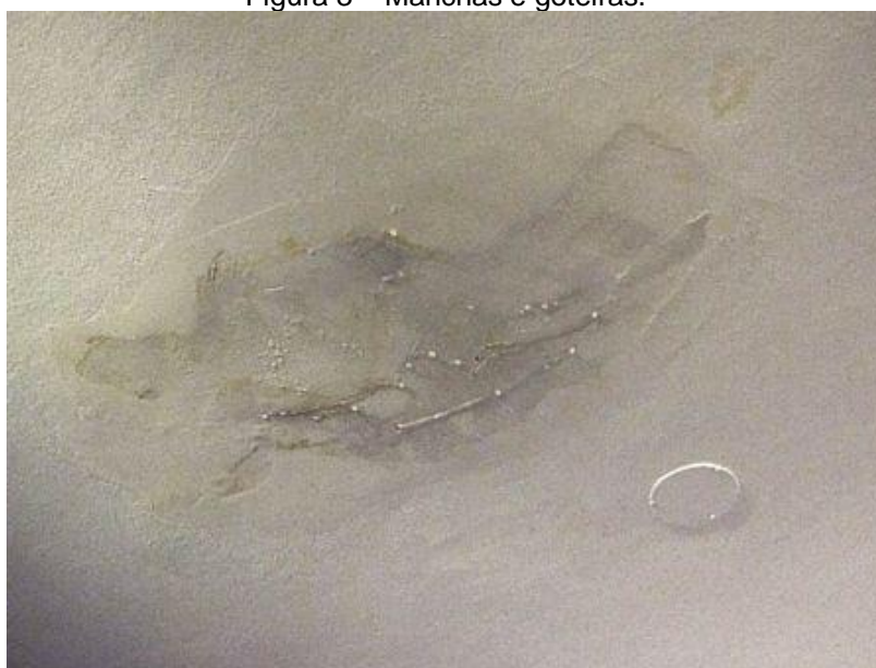
Figura 3 – Manchas e goteiras.
