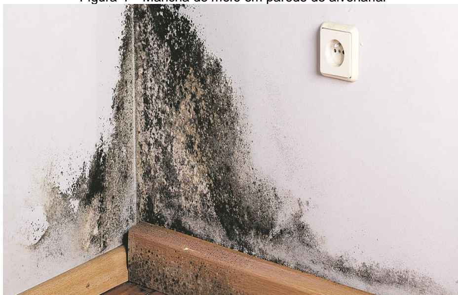
Figura 4 – Mancha de mofo em parede de alvenaria.
