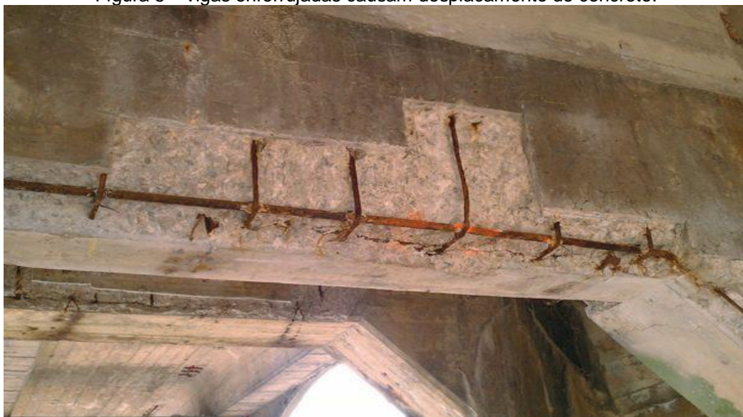
Figura 5 – vigas enferrujadas causam deslocamento de concreto.
