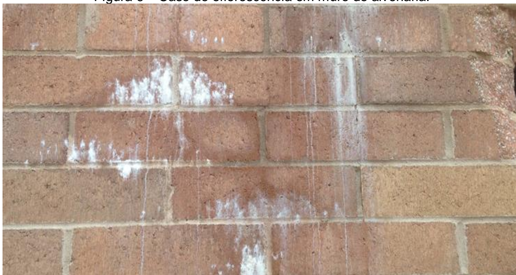
Figura 6 – Caso de eflorescência em muro de alvenaria.
