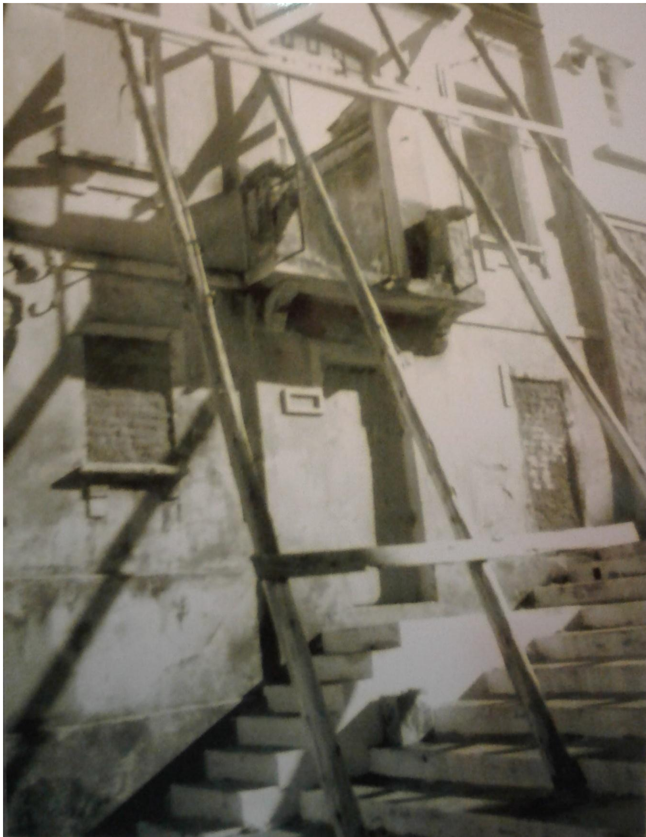
Figura 6 – Fachada do Teatro da UBRO escorada pelos bombeiros
