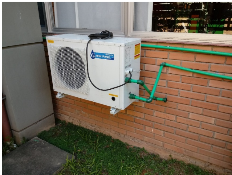
FIGURA 8 - Bomba de calor utilizada no experimento.
