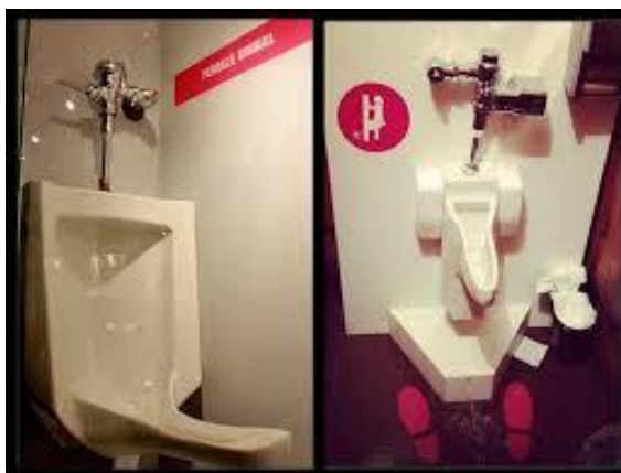
Figura 35 - Mictório em banheiro público
