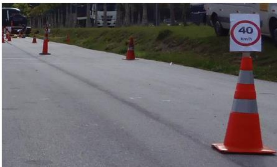
Figura 2: Placa R-19 velocidade máxima permitida de 40 km/h no sentido decrescente da BR116, km 145.
