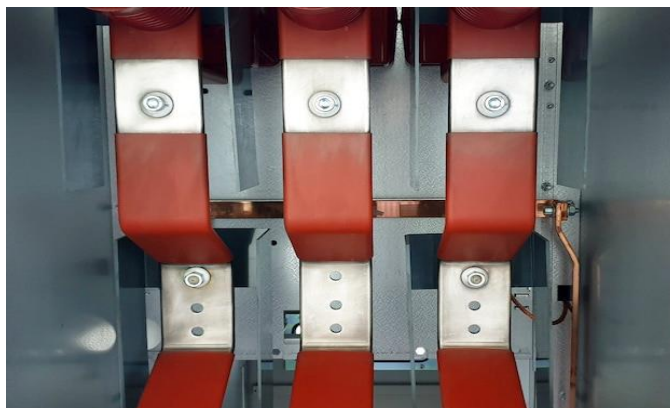
Figura 9 - Barramento de média tensão
