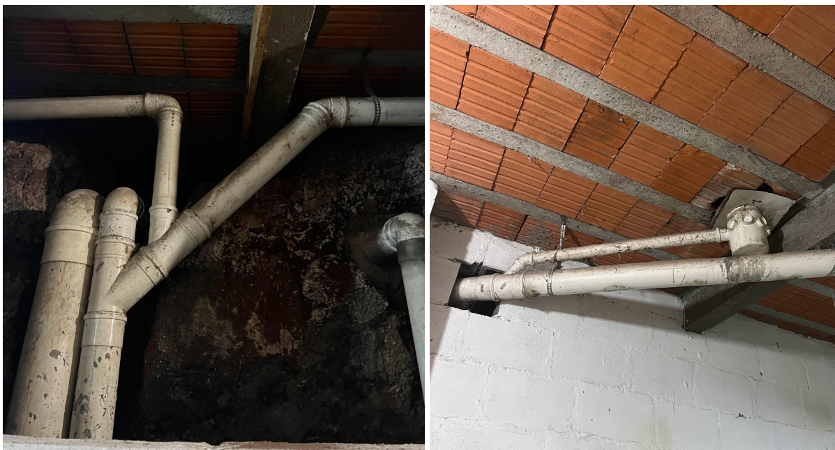
Figuras 24 e 25 - Tubulações existentes na edificação para condução de água de chuva
