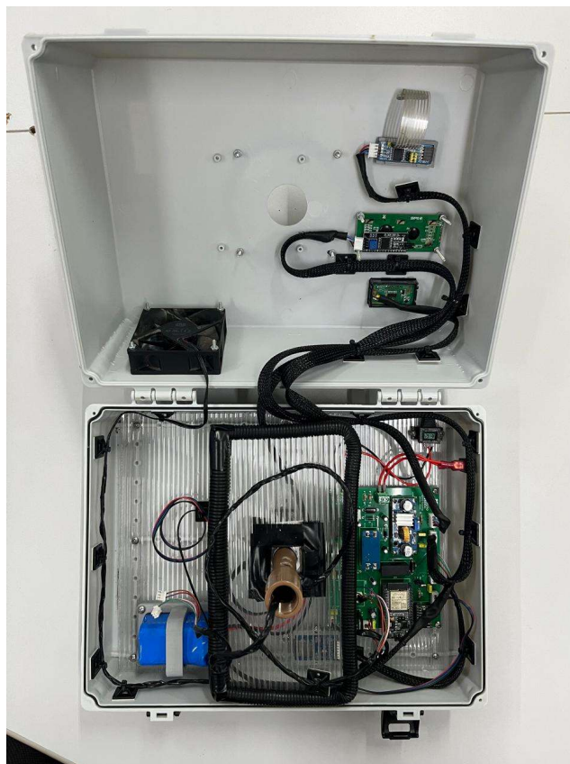
Figura 42 – Vista interna do sistema didático
