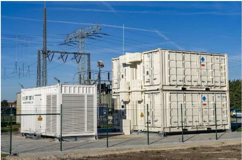
Figura 16 - Baterias de enxofre-sódio da NGKilits na Europa Oriental em operação na Bulgária
