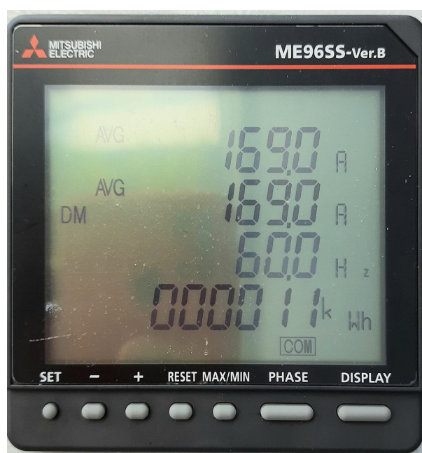
Figura 17 – Medidor de grandezas elétricas instalado no painel da EEE 21.
