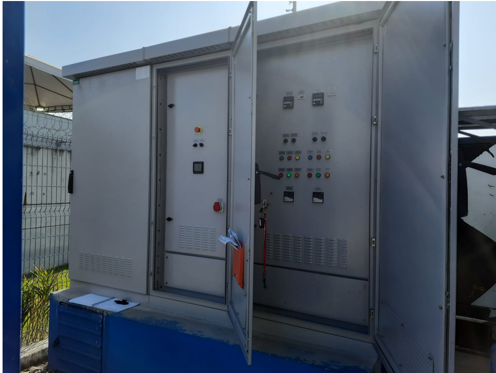
Figura 14 – Painel de comando da EEE 21.
