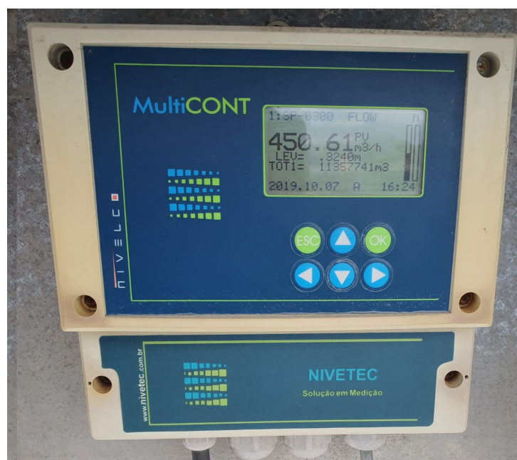
Figura 20 – Central eletrônica de monitoramento do medidor de vazão de entrada da ETE.
