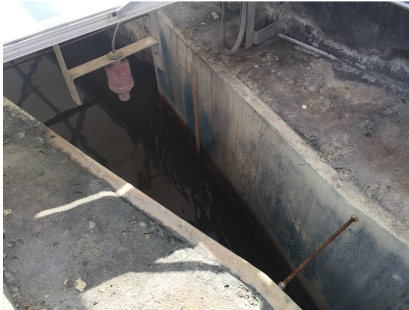
Figura 19 – Calha Parshall utilizada para medição de vazão da EEE 21.
