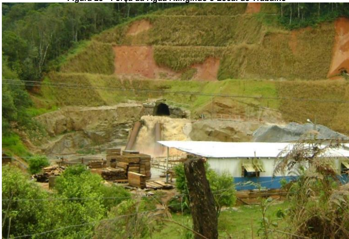
Figura 25 - Força da Água Atingindo o Local de Trabalho
