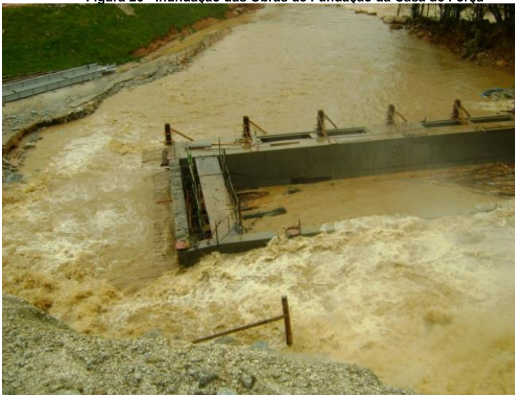
Figura 26 - Inundação das Obras de Fundação da Casa de Força
