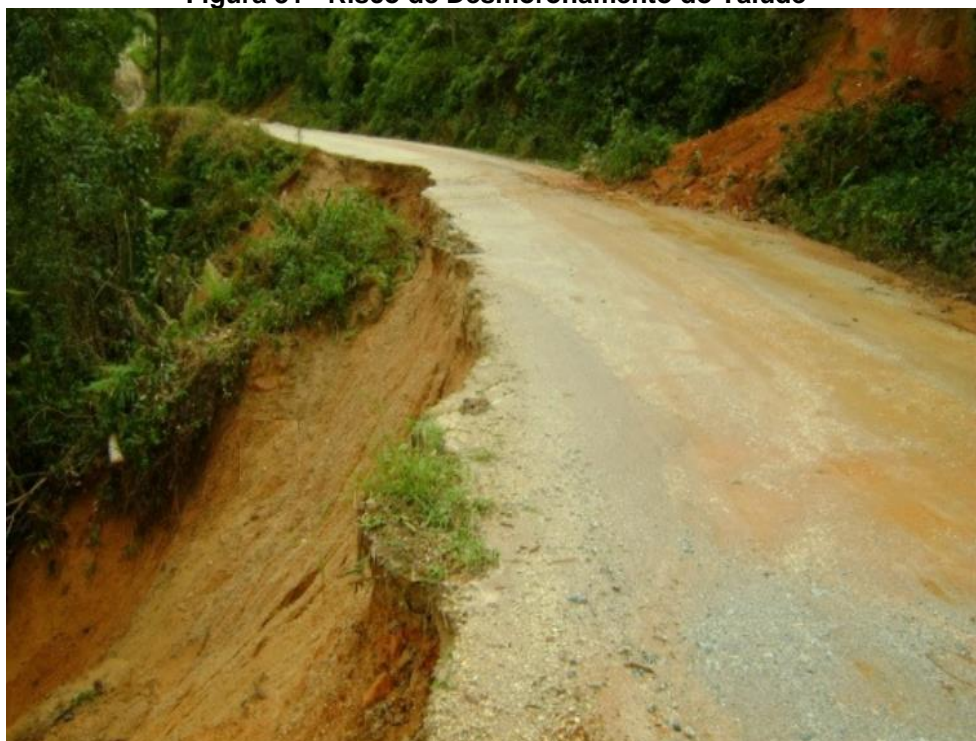
Figura 31 - Risco de Desmoronamento do Talude
