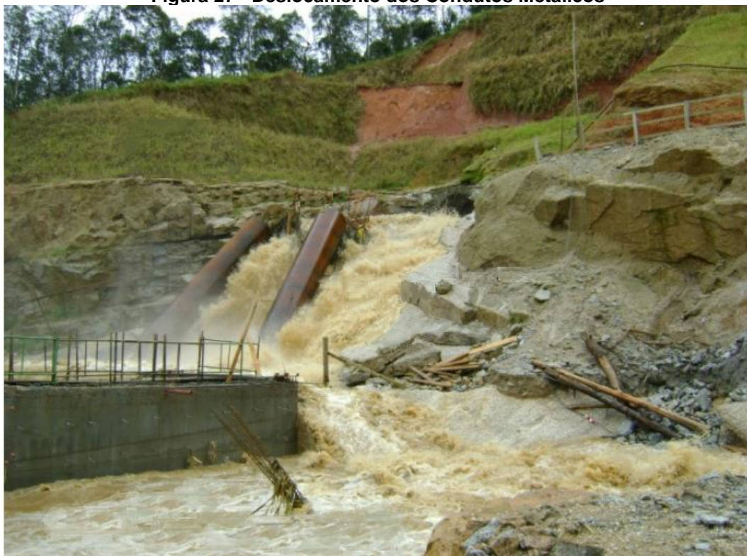
Figura 27 - Deslocamento dos Conduitos Metálicos
