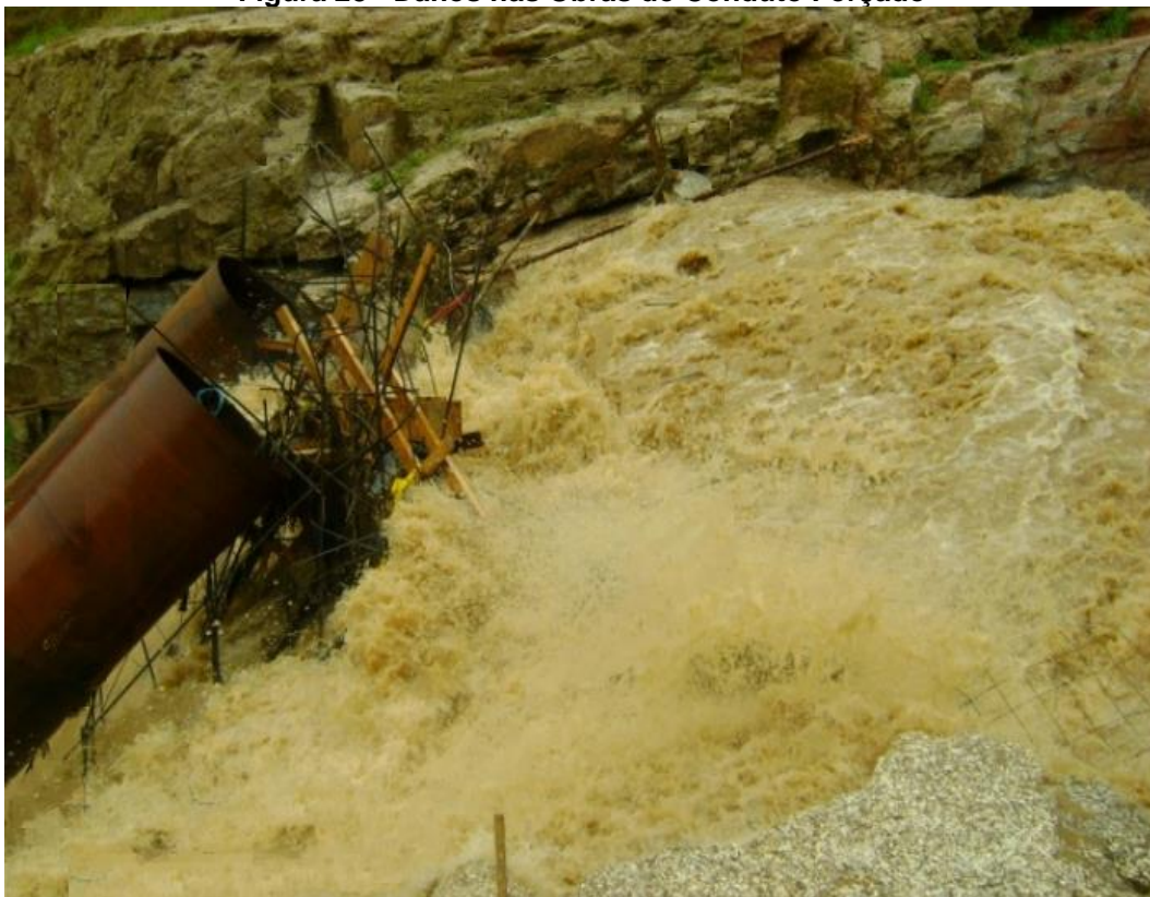
Figura 28 - Danos nas Obras do Conduto Forçado
