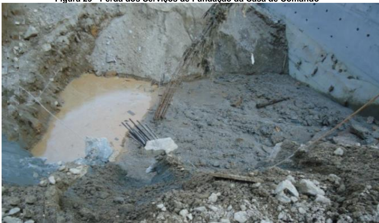
Figura 29 - Perda dos Serviços de Fundação da Casa de Comando
