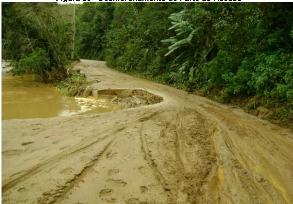
Figura 30 - Desmoronamento de Parte do Acesso
