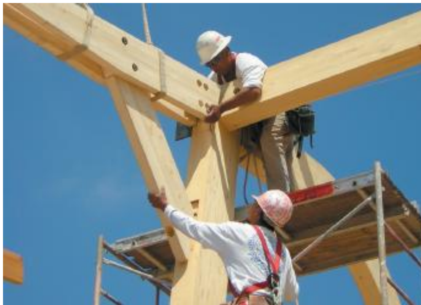
Figura 14: Içamento com guindaste de viga em MLC com cinta de tecido não abrasivo
