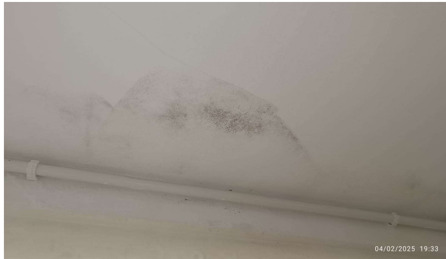
Figura 22 – Umidade manifestada na escada.
