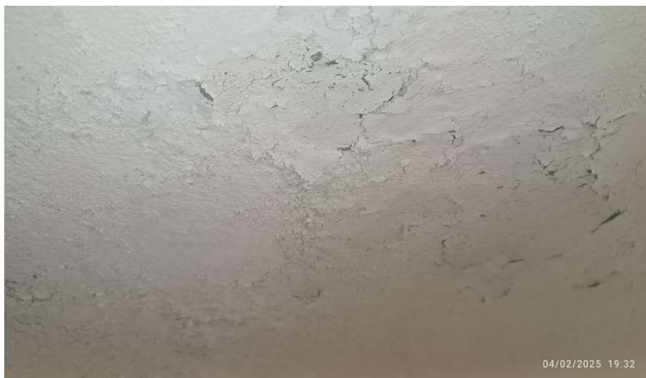
Figura 27 – Descolamento de tinta na fachada norte.
