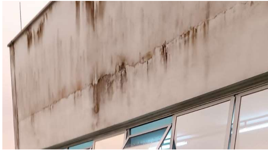
Figura 16 – Fissura na fachada norte entre viga e platibanda da fachada.
