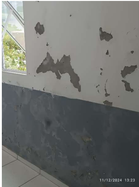
Figura 9 - Eflorescência em parede interna do primeiro piso.
