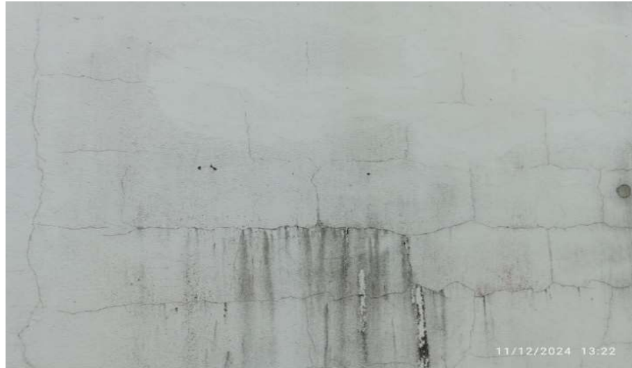
Figura 17 - Fissuras no contorno dos blocos da alvenaria, fachada oeste.
