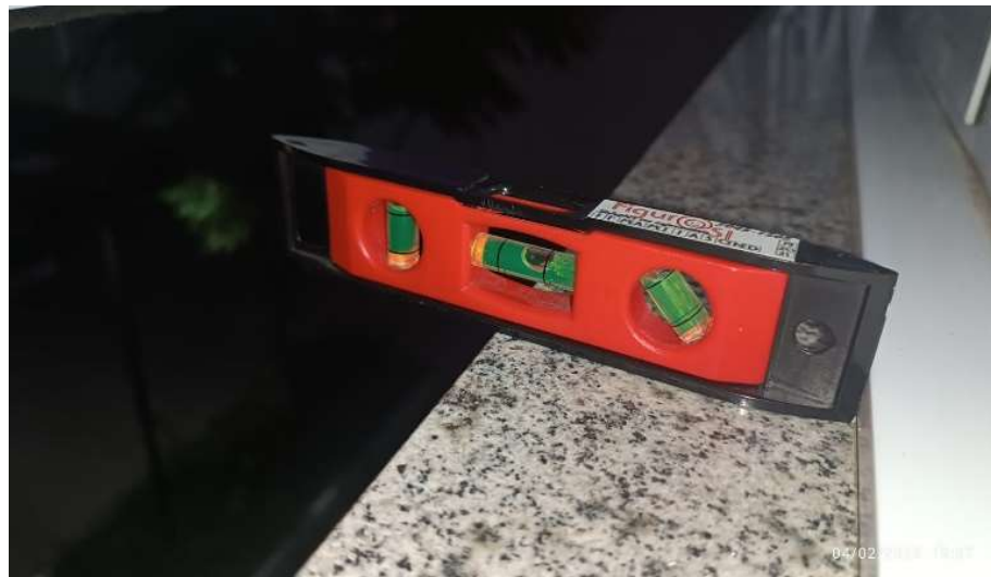
Figura 41 - Pingadeira em peitoril de janela com inclinação incorreta.
