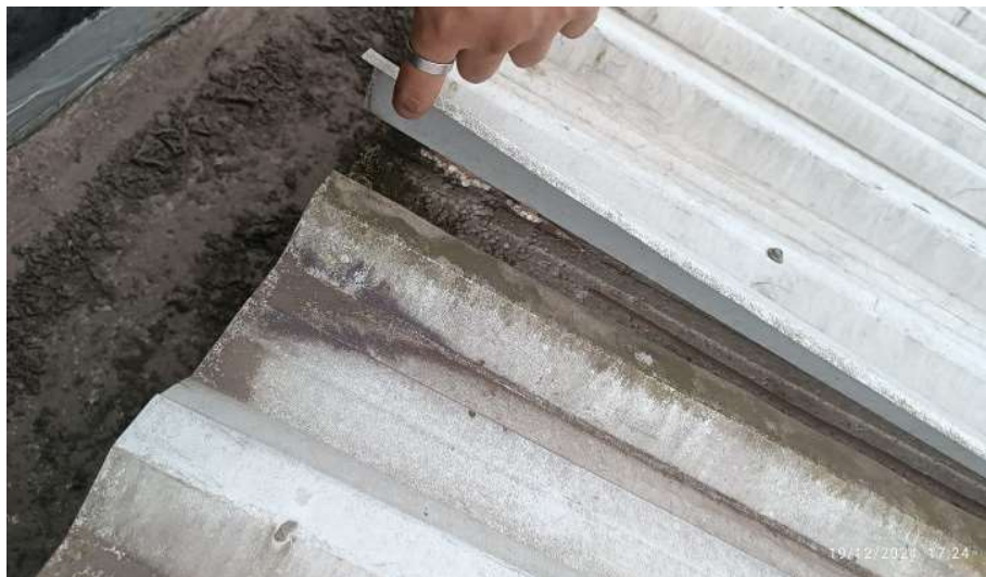
Figura 36 – Defeitos na fixação de telhas, telha solta.
