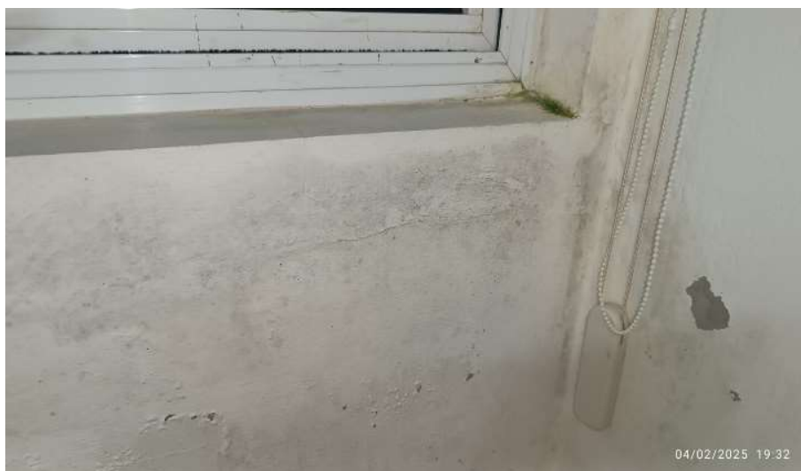
Figura 26 – Bolor abaixo de janela da sala D11.
