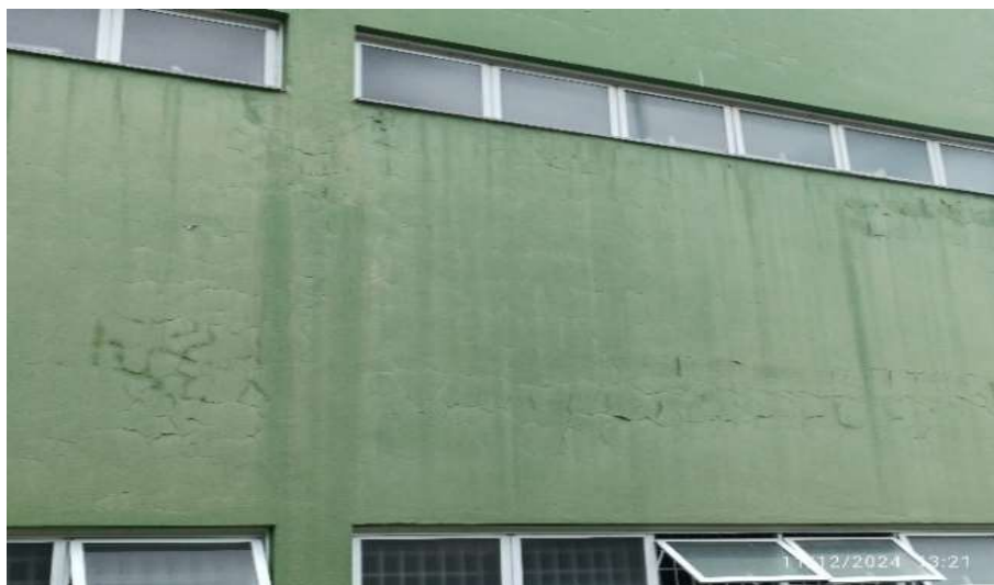
Figura 18 - Fissuras na argamassa na fachada norte entre pavimentos.
