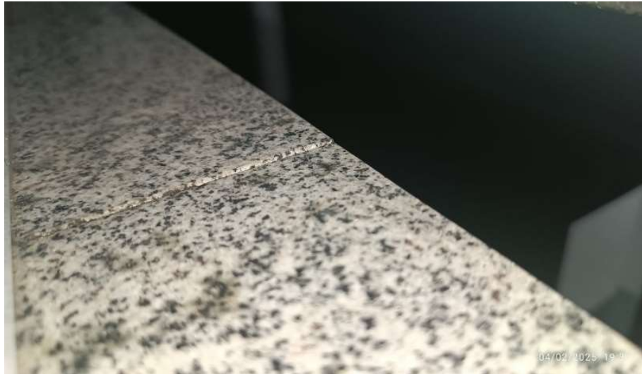
Figura 44 – União entre pedras do peitoril desalinhada.
