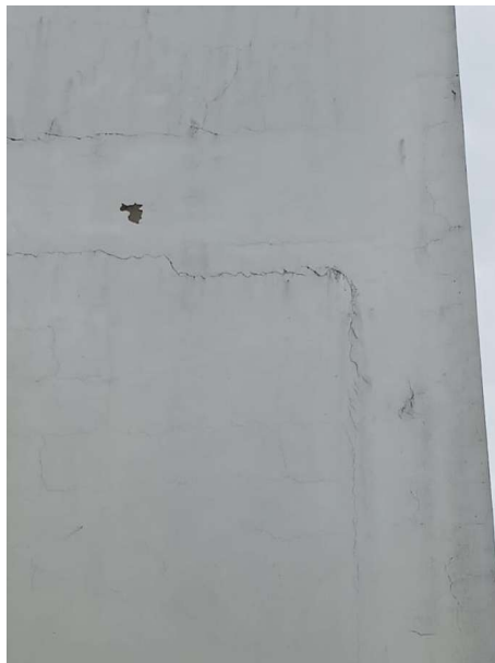
Figura 15- Fissura no contorno entre viga e pilar, fachada oeste.
