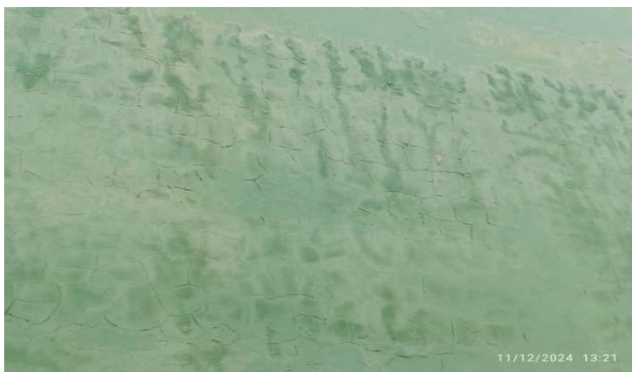
Figura 19 – Fissuras mapeadas em fachada oeste.
