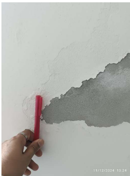
Figura 28 – Descolamento de tinta parede interna oeste no corredor do segundo pavimento.
