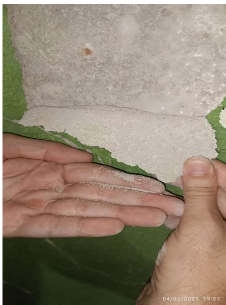
Figura 51 – Pulverulência em fachada norte.
