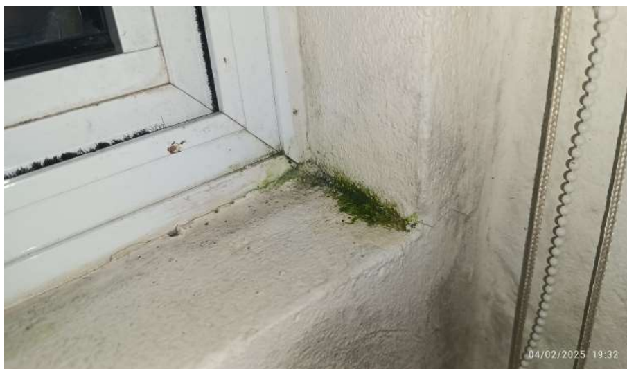
Figura 25 – Fungo aparente em janela da sala D11.
