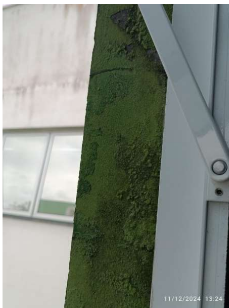
Figura 13 – Empolamento da janela oeste externo, corredor, segundo pavimento.
