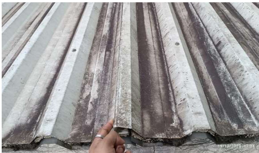
Figura 37 – Fixação inadequada de telhas.
