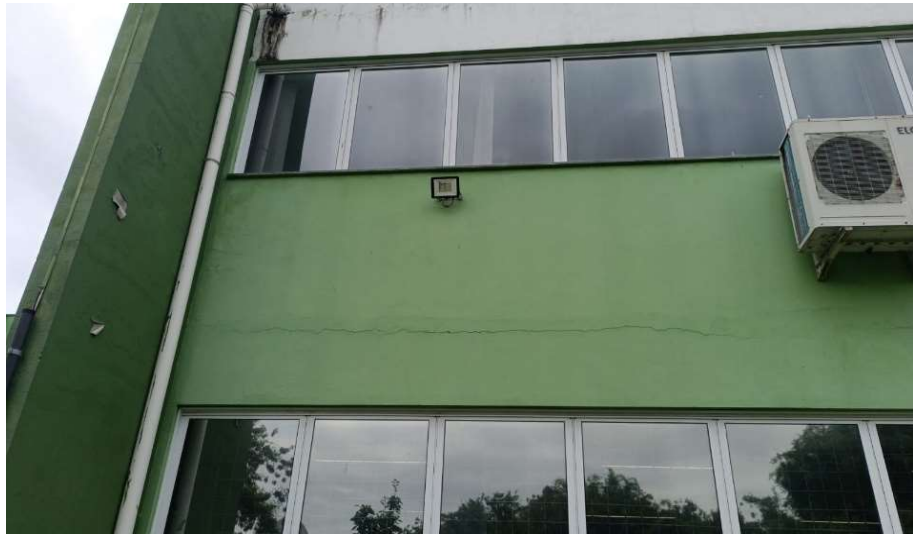
Figura 14 – Fissura entre viga e alvenaria do segundo pavimento, fachada leste.
