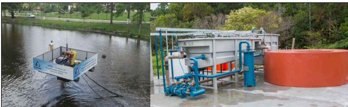
Figura 18 – Sistema de captação e tratamento da URA Rio do Braz
