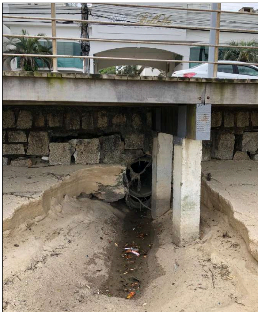
Figura 58 – Vista da saída da galeria pluvial no Ponto 9 – Residencial BelleVie
