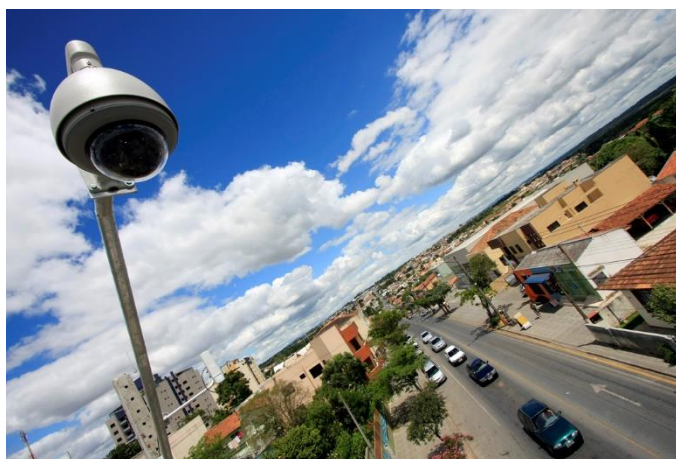
Figura 1 – Câmera Speed Dome instalada em área pública
