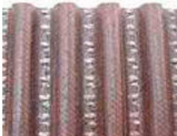
Figura 8- Exemplo de falha por tensionamento indevido
