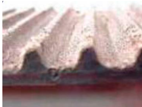
Figura 10- Exemplo de falha por sub-tensionamento 2
