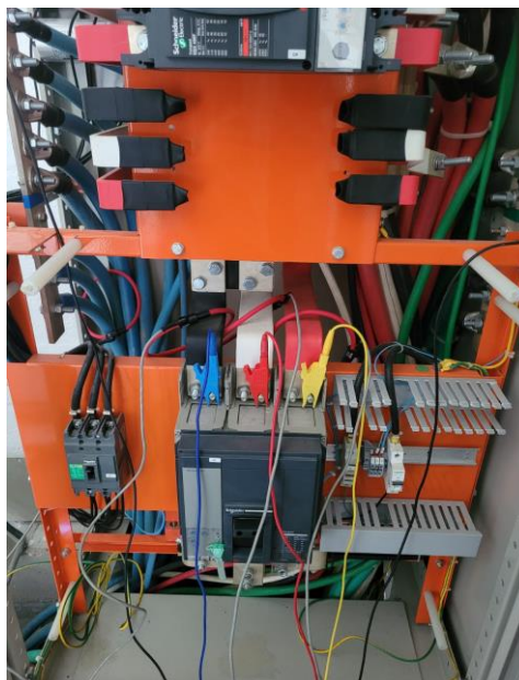
Figura 7: Instalação do analisador na subestação.
