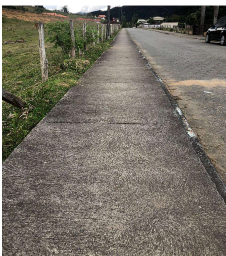
Figura 25 – Calçada sem guia de balizamento
