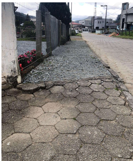
Figura 26 – Calçada com pavimentação inadequada
