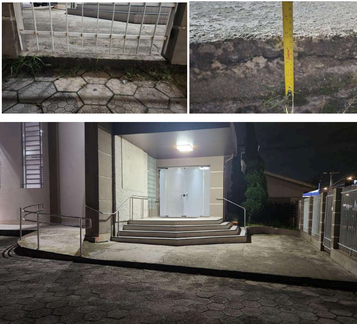
Figura 40 – Desnível e escadas da edificação sem presença de rampas ou equipamento eletromecânico
