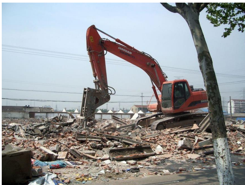
Figura 1 - RCC depositados irregularmente
