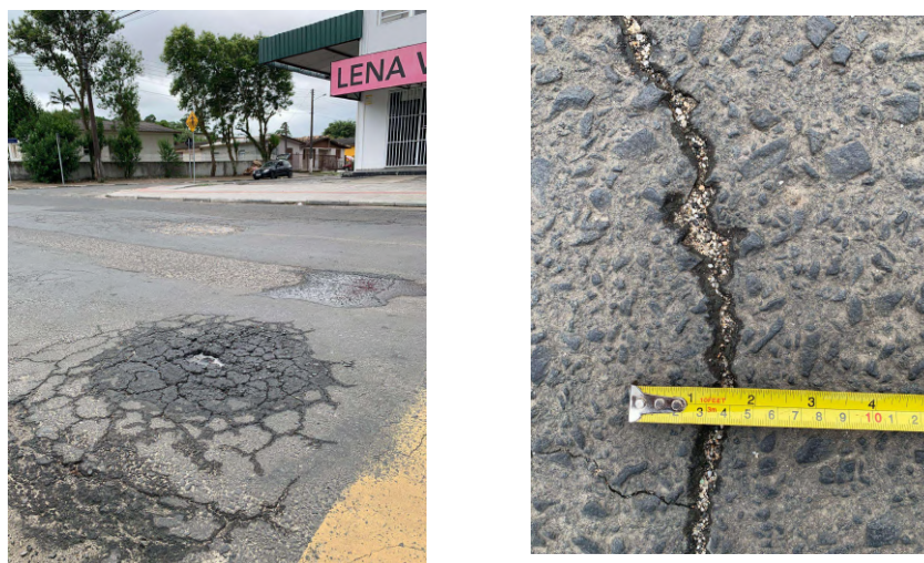
Figura 07: detalhe de uma patologia
