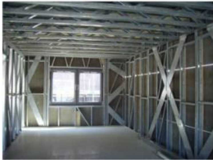
Figura 12 - Diagonais de Contraventamento do Sistema LSF
