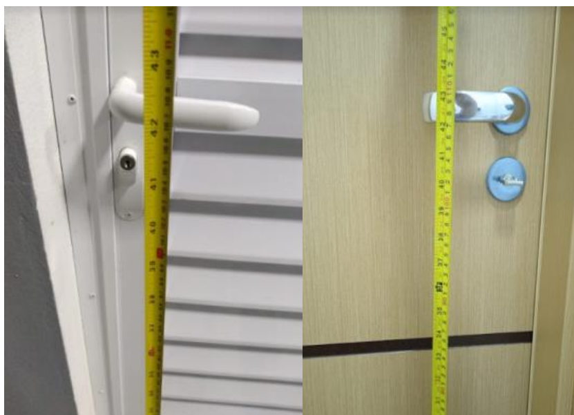
Figura 26 – Maçanetas portas de acesso aos banheiros
