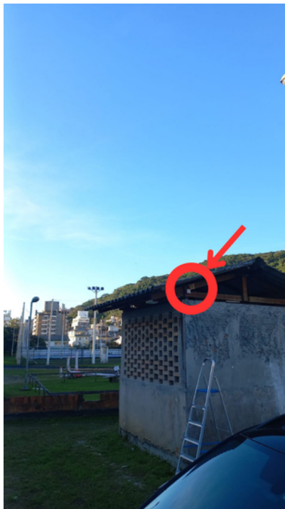
Figura 40 – Local de instalação do dispositivo D
