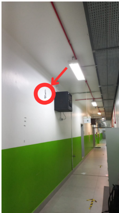
Figura 39 – Local de instalação do dispositivo C
