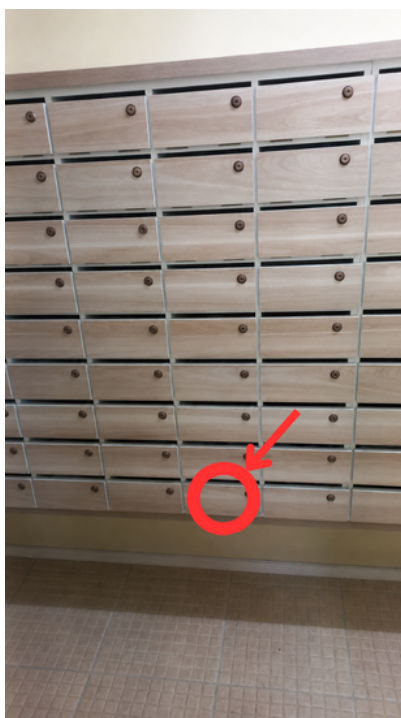
Figura 37 – Local de instalação do dispositivo presente no térreo
